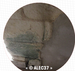
Exemple sur la compatibilité des matériaux face à l'humidité. Remontées capillaires et développement fongiques dus à la réalisation d'un enduit ciment réalisé en intérieur sur pierre calcaire tendre
