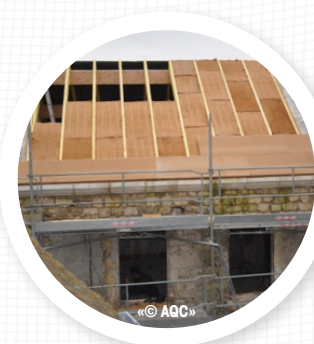
Défaut de protection en phase chantier.
