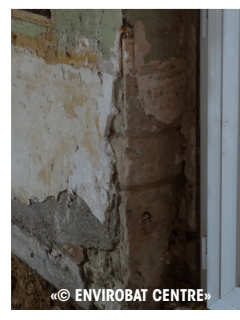
Gonflement de la partie basse du mur : Remontées capillaires, matériaux étanches et accumulation d'humidité.
