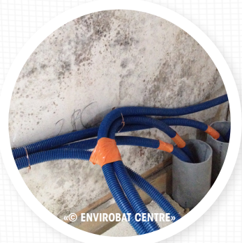
Développement de moisissure suite à la mise en œuvre de matériaux inadaptés, étanche à la vapeur d'eau : Enduit, peinture.
