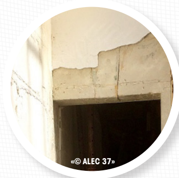
Décollement de l'enduit ciment non adapté au matériau support.
