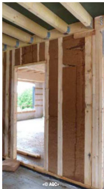
Infiltration d'eau en phase chantier entraînant le tassement et la déformation de l'isolant.
