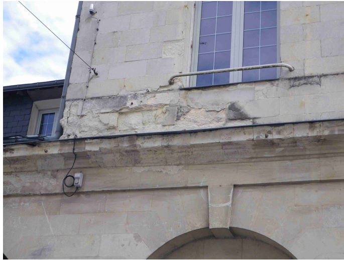
Figure 2-22 : Corniche coiffée de zinc, l'eau stagnante a dégradé le tuffeau en dessous
