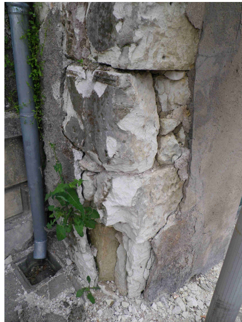
Figure 2-21 : Pierres de taille d'angle dégradées à cause de l'enduit ciment appliqué par dessus
