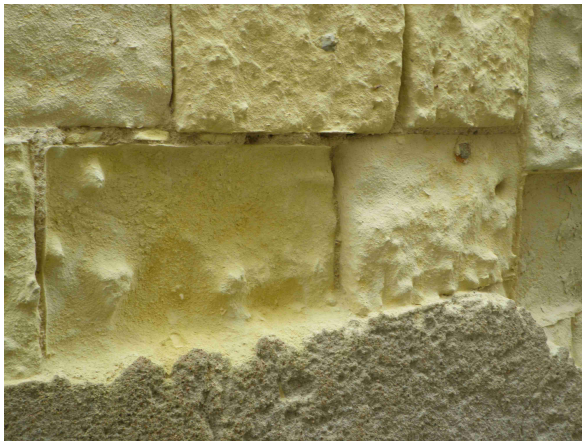
Figure 2-20 : Pierres de taille en tuffeau dégradées par alévolisation à l'interface avec le soubassement. Celui-ci a été enduit de ciment, le rendant étanche $
